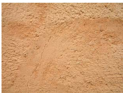
Fig. 25 - Aspecto da argamassa tipo C – painel 3, apresentando alguma fissuração
