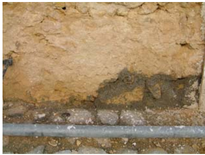
Fig. 33 - Pormenor de buraco pré-existente tapado com cimento na zona inferior do painel 2
