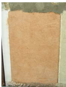
Fig. 23 - Aspecto final do painel 3 - Argamassa tipo C
