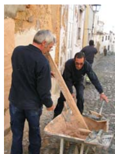
Fig. 36 - O excedente de argamassa é depositado no carrinho de mão, constituindo desperdício
