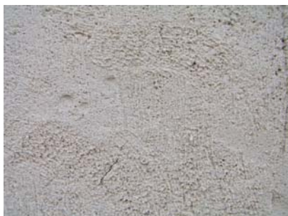
Fig. 37 - Aspecto da argamassa tipo D – Painel 4
