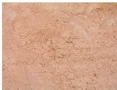
Fig. 18 - Pormenor de fissuração da primeira camada da argamassa tipo C – painel 3
