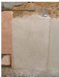
Fig. 37 - Aspecto da argamassa tipo B – painel 2, 16 dias após a sua aplicação
