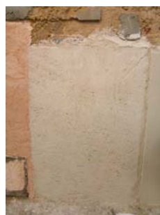
Fig. 34 - Aspecto da argamassa tipo B – painel 2, 16 dias após a sua aplicação
