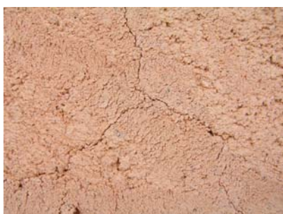
Fig. 19 - Pormenor de fissuração concêntrica da primeira camada da argamassa tipo C – painel 3
