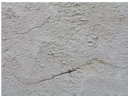
Fig. 17 - Fissura na mesma camada (na ordem dos 3-4 mm)
