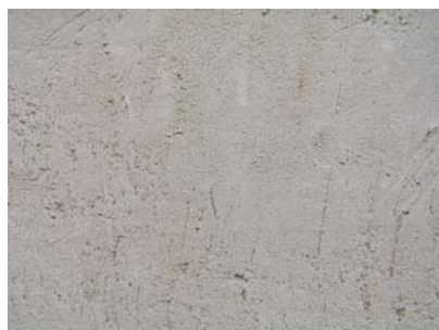
Fig.48 - Aspecto da textura da argamassa tipo B
