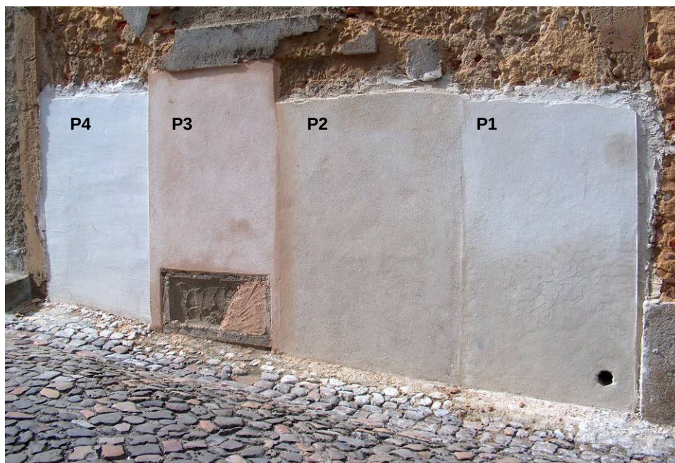
Fig. 3 – Aspecto geral dos painéis da Rua Contra-Almirante Jaime Afreixo, 90 dias após aplicação das 2 as camadas
