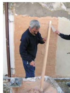
Fig. 8 - O excedente de argamassa é depositado no carrinho de mão, constituindo desperdício
