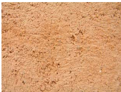
Fig. 35 - Aspecto da argamassa tipo B – Painel 2
