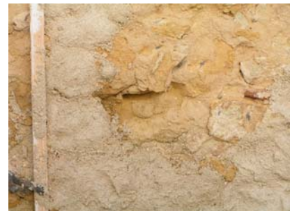
Fig. 38 - Pormenor de lacuna na alvenaria, com profundidade aproximada de 5-6 cm
