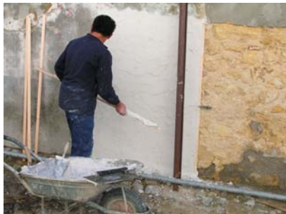
Fig. 25 - Material excedente na ripa de madeira
