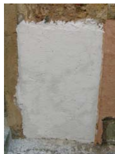
Fig.44 - Aspecto final da argamassa tipo D – Painei 4, após 16 dias da sua aplicação
