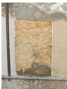
Fig. 43 - Aspecto do suporte em alvenaria antiga do painel 3
