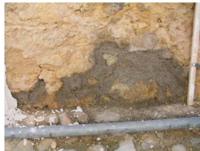
Fig. 32 - Pormenor de buraco preexistente tapado com cimento na zona inferior do painel 3
