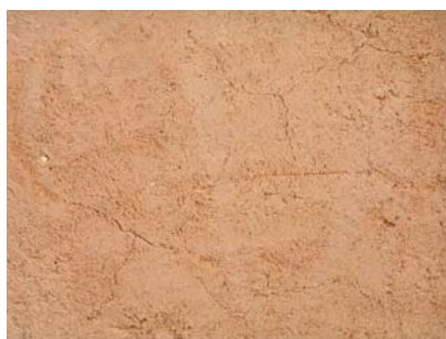
Fig. 8 - Fissuração da primeira camada da argamassa tipo C após 24 horas
