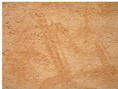
Fig. 24 - Aspecto da argamassa tipo C – painel 3, apresentando alguma fissuração
