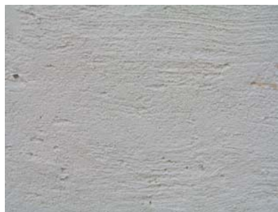
Fig.36 - Aspecto da argamassa tipo C – Painel 3
