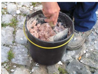
Fig. 7 - Um litro de água não foi suficiente para finalizar adequadamente a amassadura
