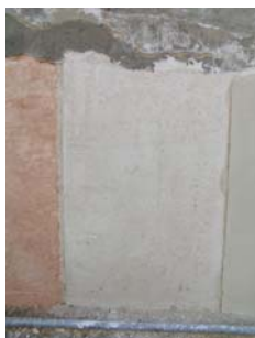
Fig. 41 - Aspecto da argamassa tipo B – painel 2, 16 dias após a sua aplicação
